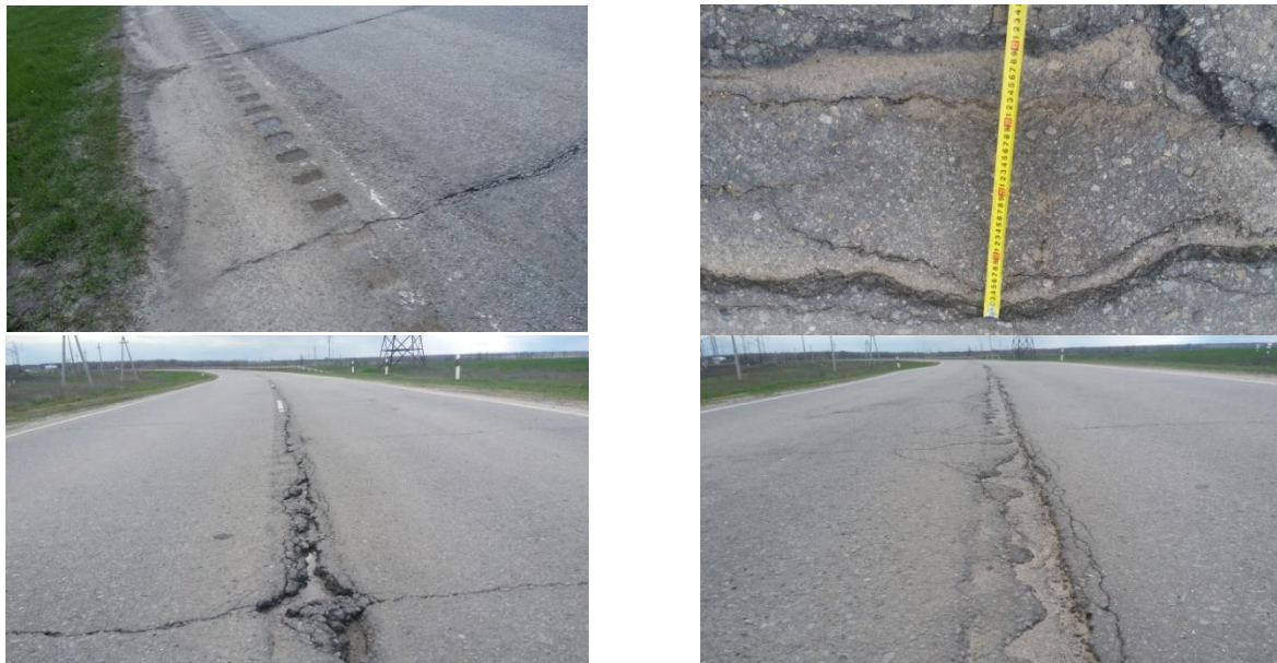
Рис. 5. Дефекты шумовой полосы (фото Скрылёва Г.В.)
