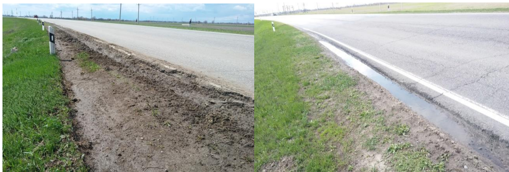
Рис.2. Криволинейный участок автомобильной дороги с неукрепленной обочиной (фото Скрылёва Г.В.)
